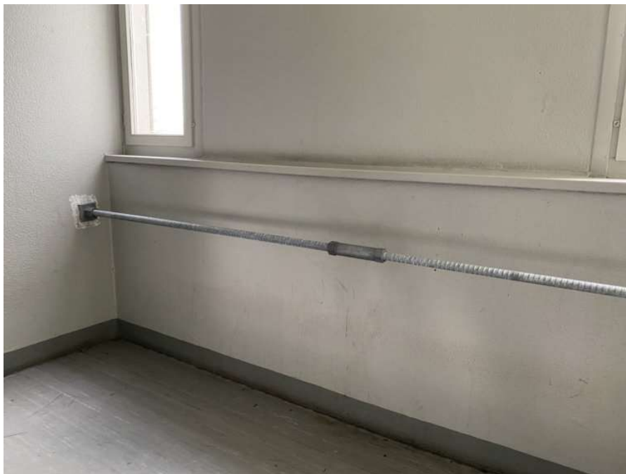
Das Treppenhaus eines Wohnblocks musste bereits mit Spriessungen versehen werden, welche die ursprüngliche Bausubstanz entlasten. (Bild: wia)
